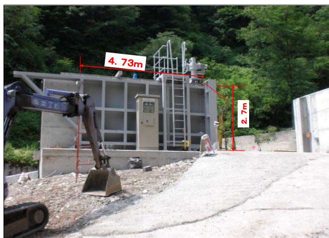
既設導流壁上流側延長部分新設門扉 (遠隔電動で開閉)
