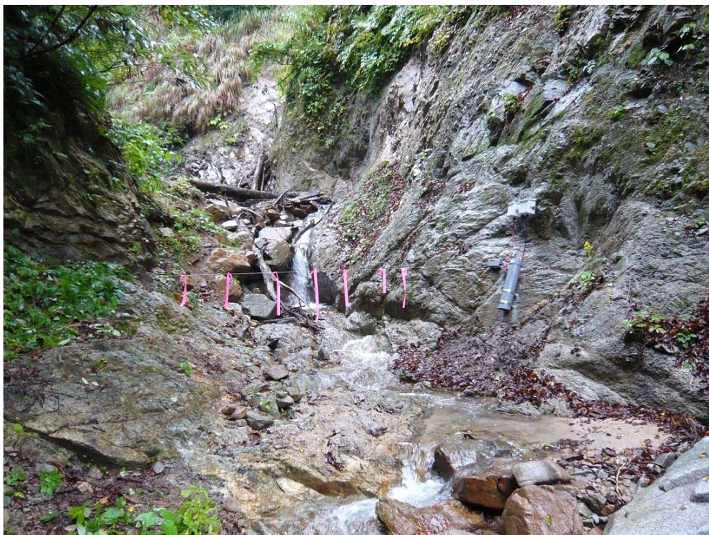
土石流監視センサー（松谷上流）設置状況
