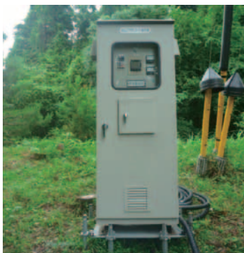
図-3 操作制御盤 外観
